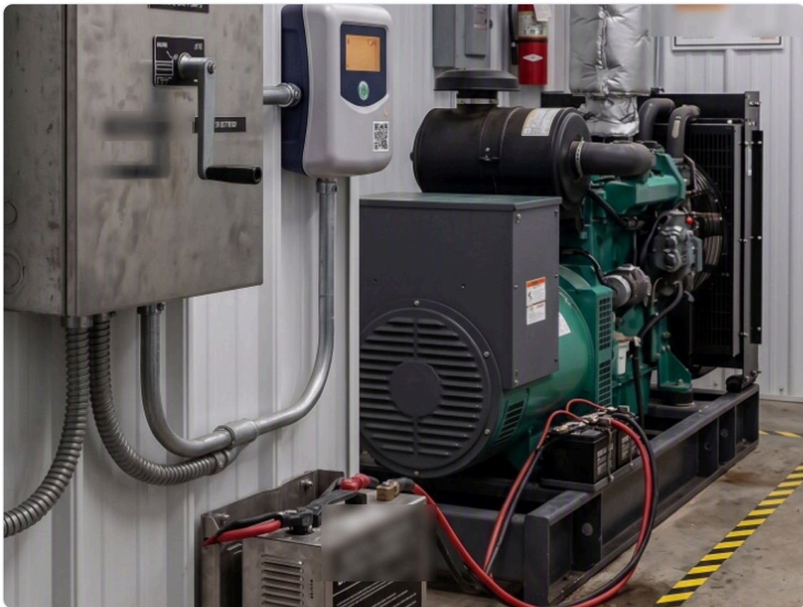
Instalación tipo. El satélite junto al tablero de transferencia, leyendo motor, alternador y baterías sin tocar el control.
